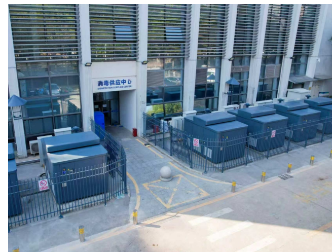
深圳三环SOFC站
